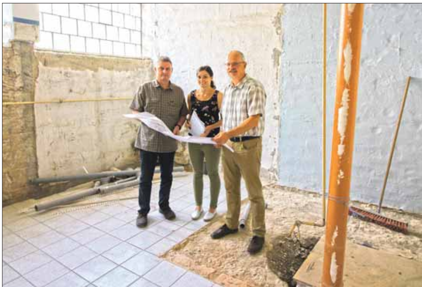
Eine einzige riesige Baustelle ist derzeit die Schule in Höpfingen. Mit nirgendwo verzeichneten alten Leitungen (rechts im Bild) hält diese so manche unangenehme Überraschung für die Arbeiter bereit. Architekt Bernhard Thiry (l.) wirft gemeinsam mit Hauptamtsleiterin Lisa Bender und Bürgermeister Adalbert Hauck einen Blick in die neuen Pläne. Fotos: Janek Mayer
